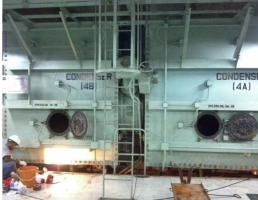
Gambar 1 Condenser PLTU Gresik Unit 4
